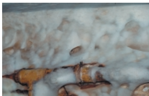
Afb. 2 Ontwikkeling van de zwamvlok van een huiszwam op een muur en op waterleidingen.
