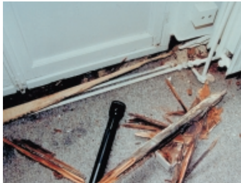
Afb. 23 De houten plinten vertoonden verdachte barstjes, wat de onderzoeker ertoe aangezet heeft deze te openen en de aanwezigheid van de huiszwam vast te stellen.
